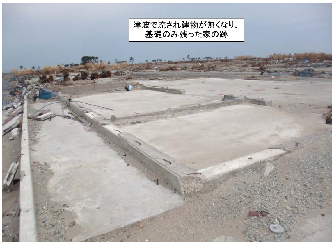
津波により建物が無くなり基礎のみ残った家の跡（2011年4月30日撮影）
