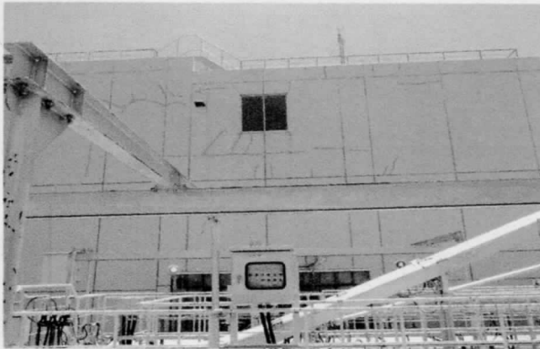
<ひび割れた外壁と錆汁の跡>
