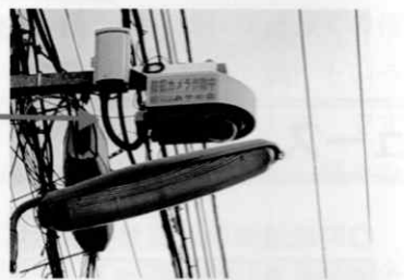
防犯カメラの設置
